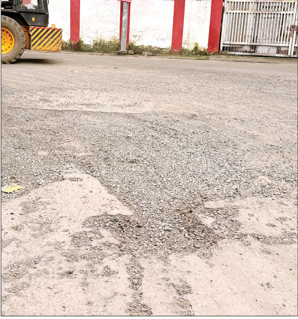
रेलवे स्टेशन पहुँच मार्ग प्लेटफॉर्म-6 यहां की सड़क बारिश की मार से उखड़ गई है। स्टेशन आने-जाने वाले यात्रियों को गड्ढों के बीच से रास्ता तलाशना पड़ रहा है।
