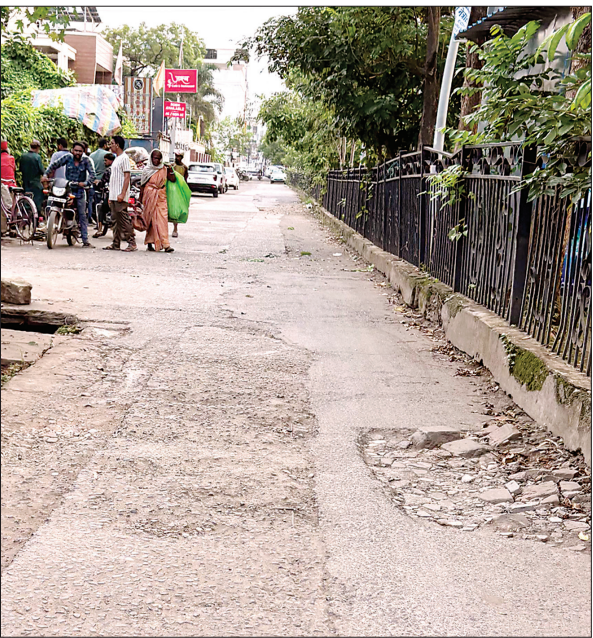
कल्चरल स्ट्रीट- सड़क भी बारिश के बाद बदहाल हो गई है। अब जरूरत सिर्फ निरीक्षण की नहीं, बल्कि जिम्मेदारों की आंख खोलने वाली तत्काल मरम्मत की है।
